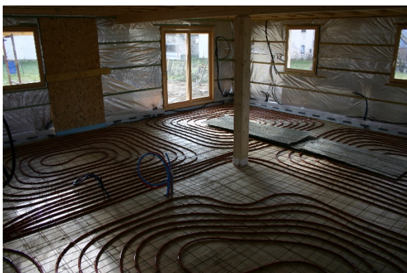
Dalle à circulation de fluide
